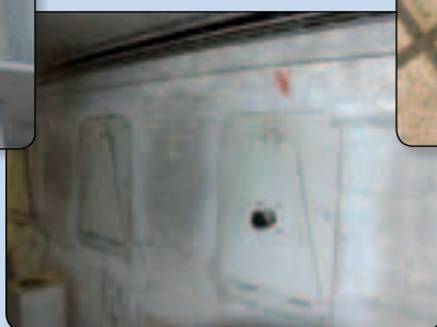
Piquage sur la trappe de ventilation en galerie sous cellules
